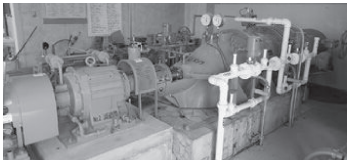
▲藤崎排水機場2号ポンプ
